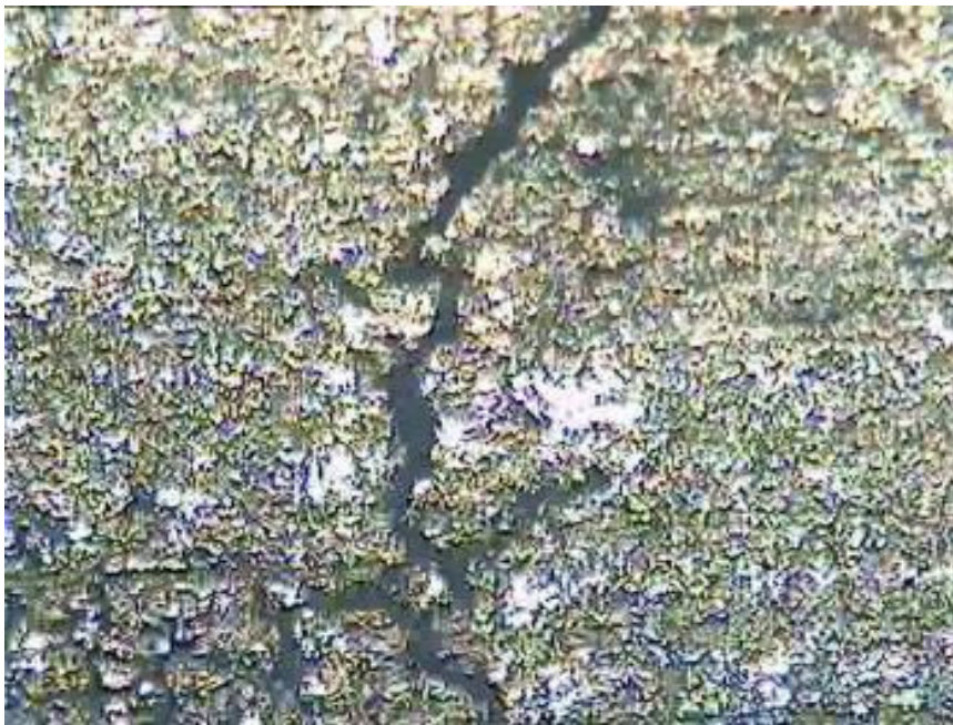
شکل ۲۹ - ۴ ترک‌های قلابی شکل
