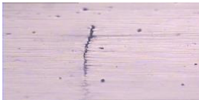
شکل ۱-۴ ترک در بدنه
